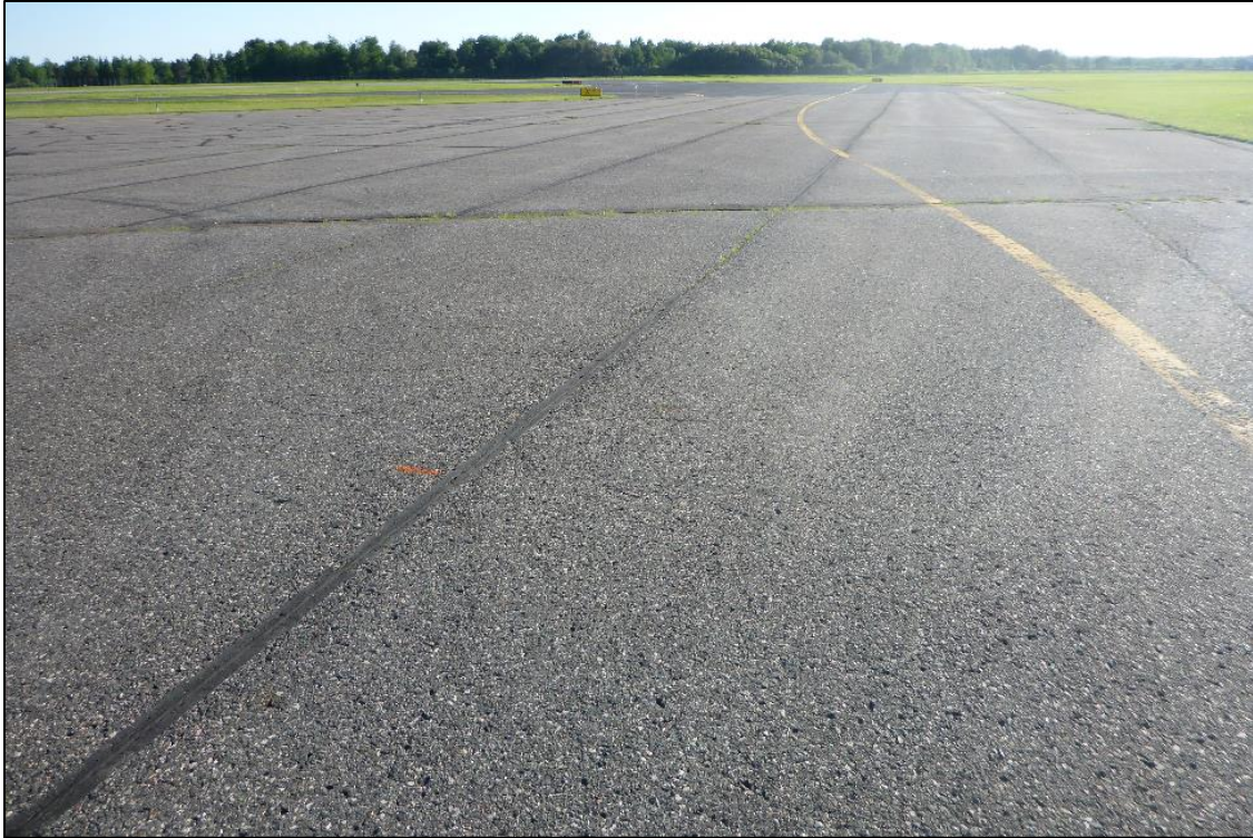
HIB APC 002 (PCI = 42)
