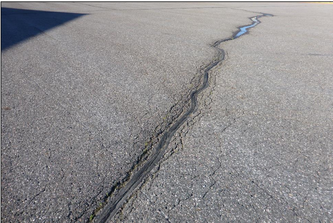
HIB APC 001 (PCI = 59)
